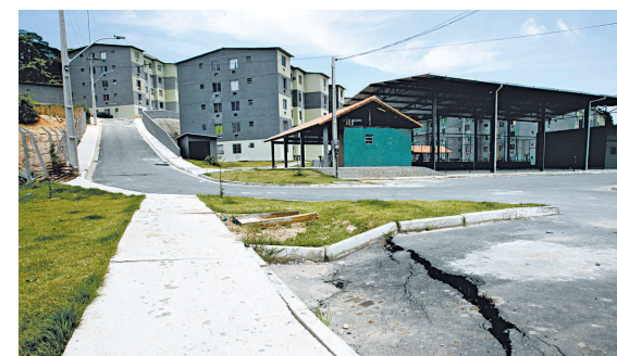
Chão do conjunto Zilda Arns já apresenta rachaduras
