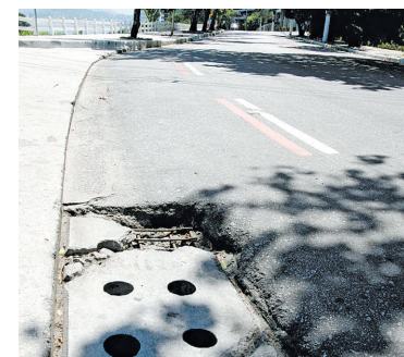
Há buracos em partes de cicloviás
